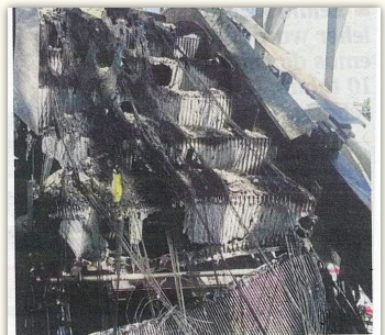
KEADAAN eskalator yang terbakar di sebuah bangunan yang dalam pembinaan berdekatan Menara TM di Jalan Pantai Baru.
