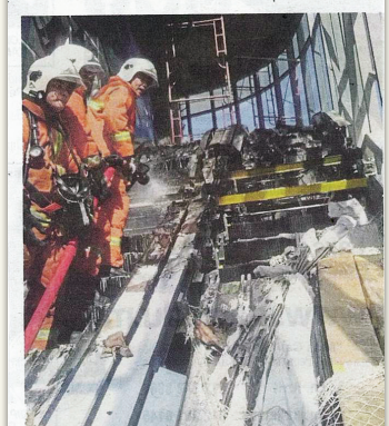
PASUKAN bomba memadamkan kebakaran eskalator di Jalan Pantai Baru.
