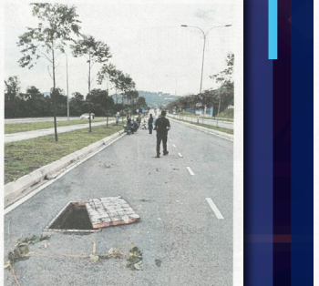
LUBANG yang dibiarkan tidak tertutup di tempat kejadian.
